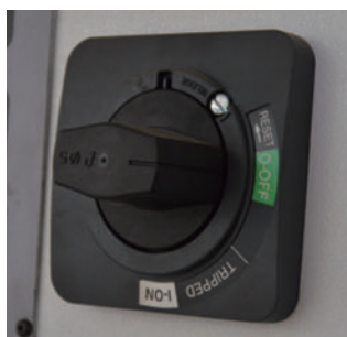
5 Центральный выключатель электропитания.
