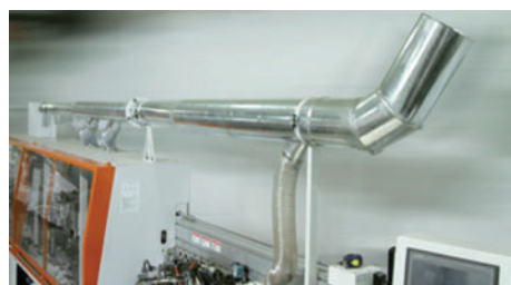
Централизованные аспирационные трубы
